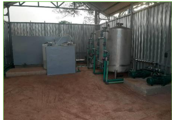
Die Wasseraufbereitungsanlage gehört zum umfassenden Konzept der SOS-Farm. © SOS-Nigeria
