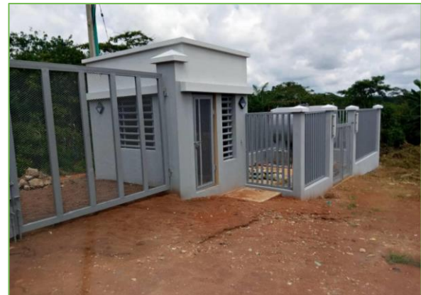
Die Infrastruktur für den Strom aus der Biogasanlage ist geschaffen. © SOS-Nigeria
